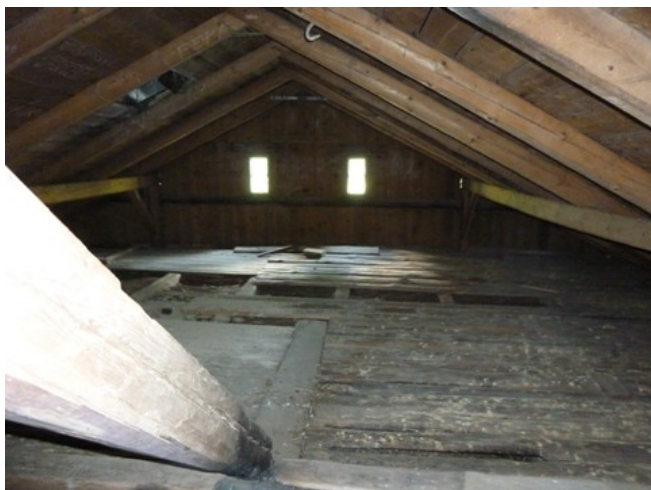
Obr 15. Stávající stav pochozí stropu nad patrem domu - Herlíkovice 7/2010
